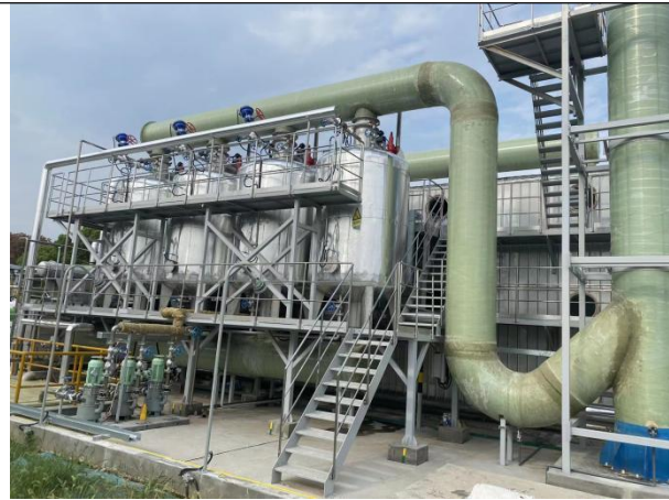
图 3-6 南片污水预处理区除雾+二级活性炭
