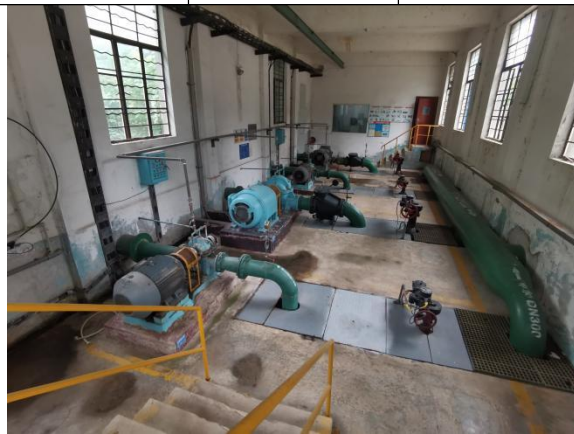
图3-10 污水处理及中水回用装置（2）
