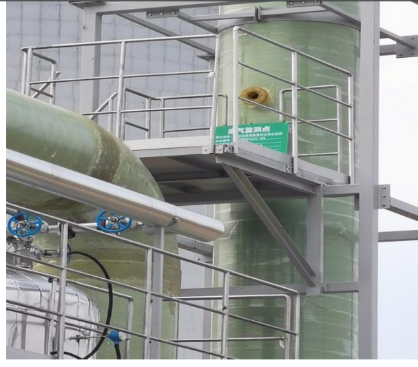
图 3-8 南片污水预处理区排口标识牌
