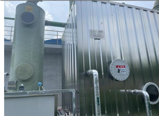
图 3-1 BDO 预处理区水喷淋+生物滤池
