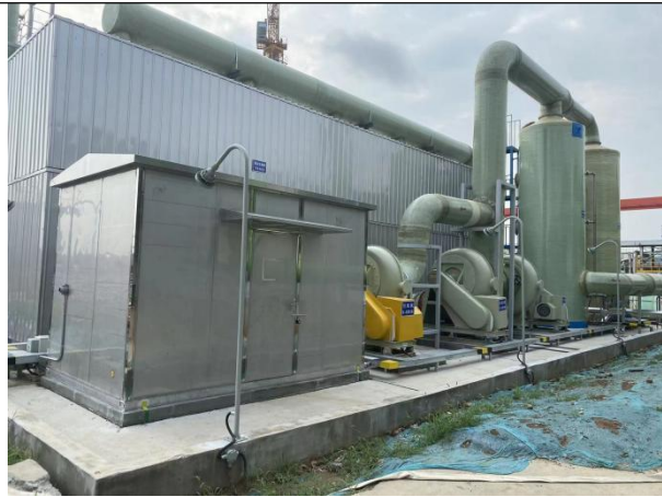
图 3-5 南片污水预处理区碱喷淋+生物滤池
