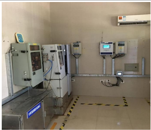
图 3-19 污水排口在线监测站房
