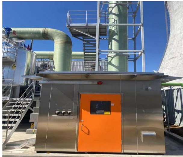
图 3-20 南片污水预处理区 P3 排口在线监测站房
