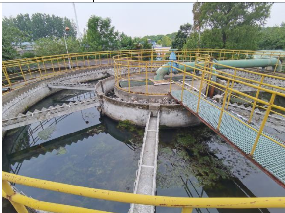
图3-9 污水处理及中水回用装置（1）
