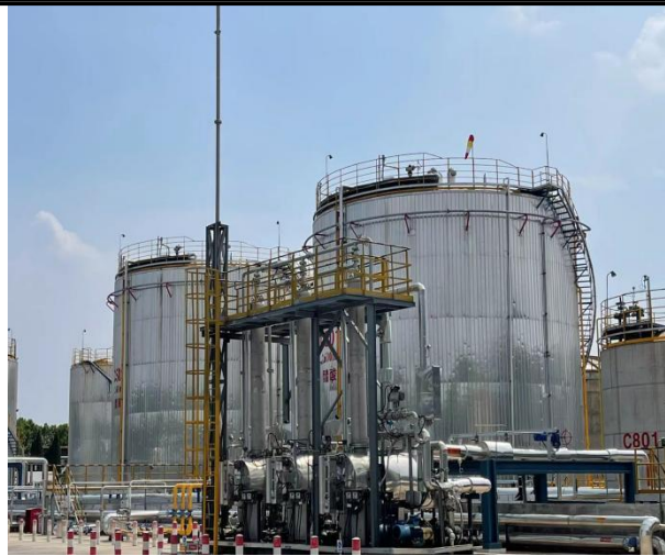
图 3-3 总罐区三级水吸收装置
