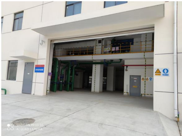
封闭厂房软连接减噪措施
