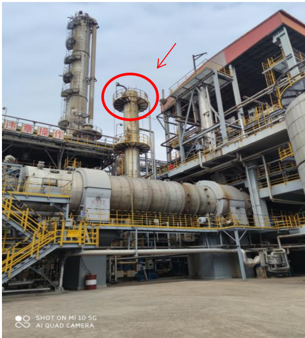
PTA1线溶剂回收单元废气处理设施及排气筒
