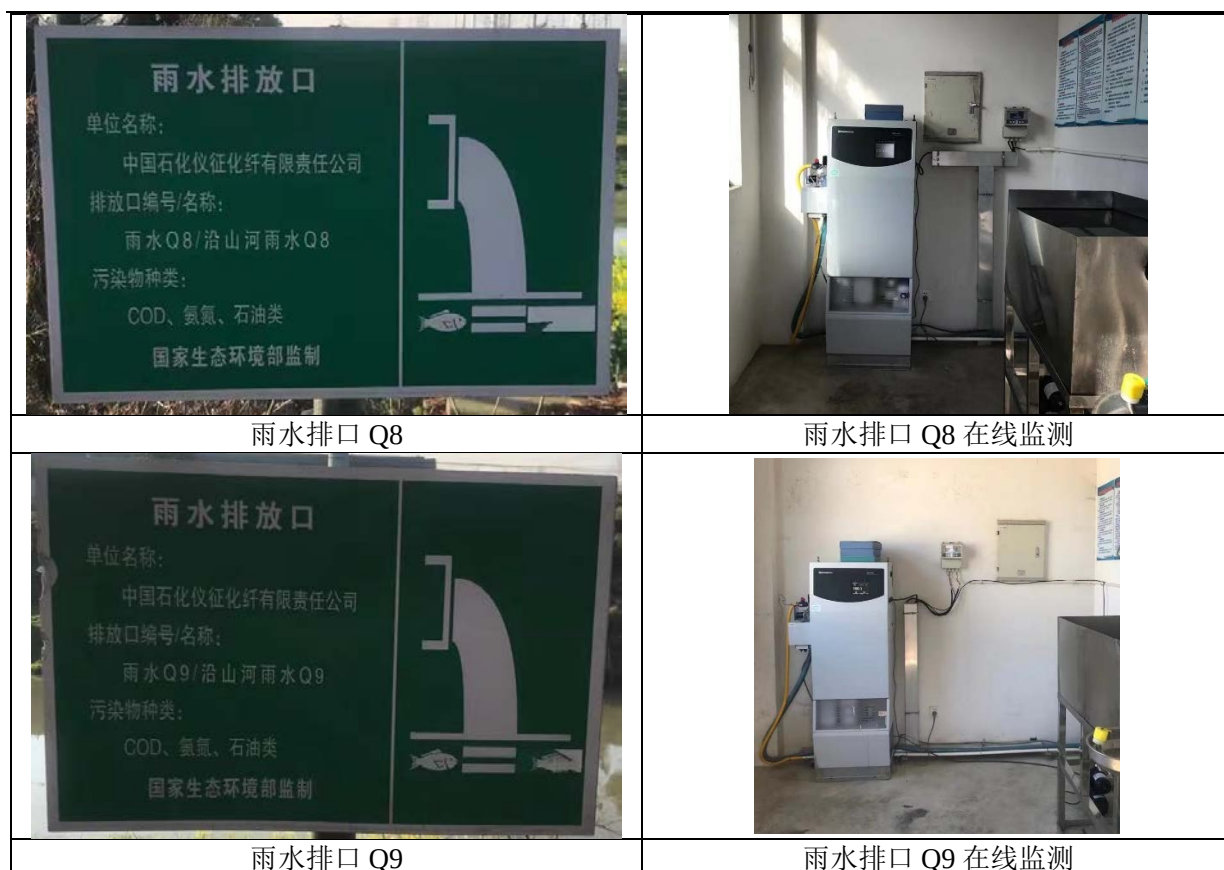
图 3.1-6 仪化公司厂区雨水排口标识图
